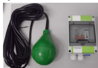
Figura 1: Sistema de deteção do nível máximo, com gestão de alarme.
